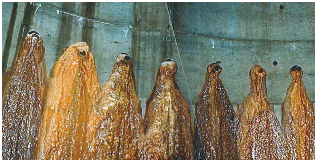
《水抜きボーリング孔の機能低下状況》
