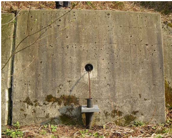
《アンカー破損状況》 アンカー定着力の低下による破損
