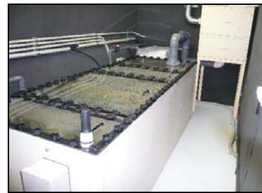
油水分離装置外観
