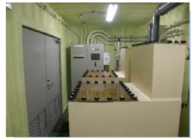
VOC処理装置ユニット内部
