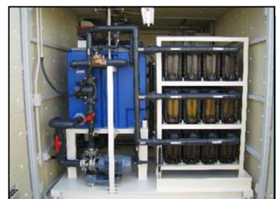
膜ろ過装置ユニット内部
