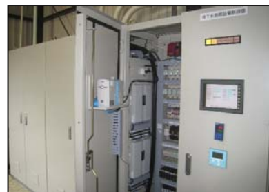
遠隔監視制御盤外観
