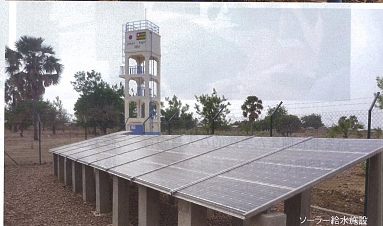
ソーラー給水施設
