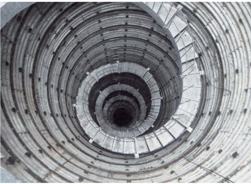
地滑り防止用水抜き井戸の「集水井」
