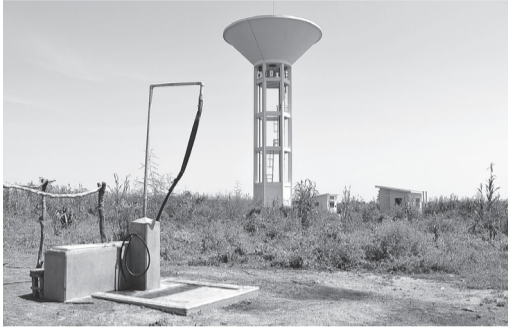
200mの高架水槽と車両用給水所
