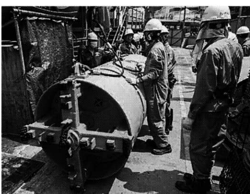
掘進機を使うホーチミンの下水道整備事業の現場(写真・ヤスタエンジニアリング提供)
