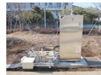
ヒートポンプユニット
