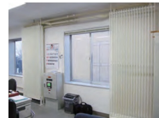
輻射式室内機・操作盤
